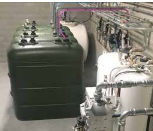
SALAS DE BOMBEO
